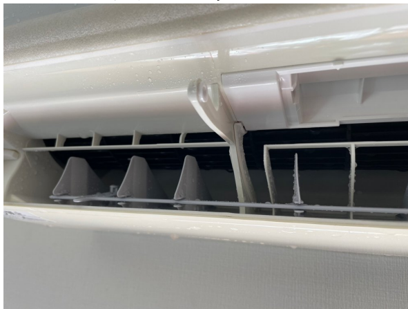
15.エアコンクリーニング
