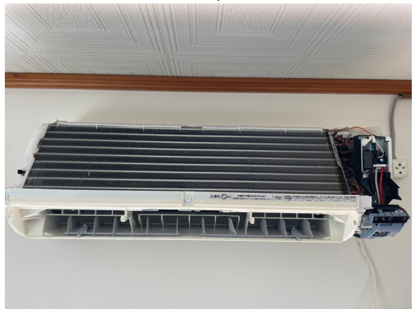
15.エアコンクリーニング
