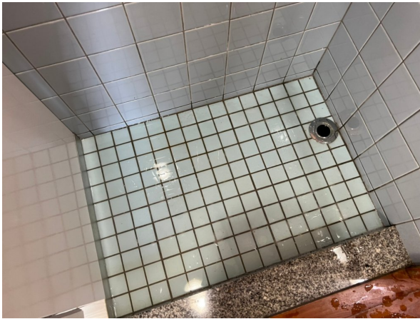
6.洗濯機防水パン
