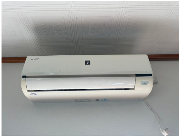
15.エアコンクリーニング
